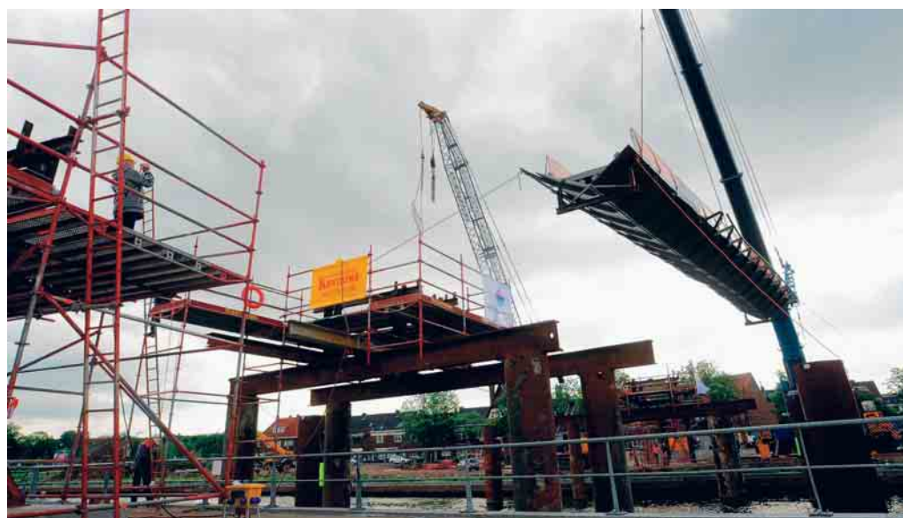
Zondagmorgen werd met zware hijskranen het grootste brugelement van de Collegebrug over de Leie geplaatst. ©Patrick Holderbeke
