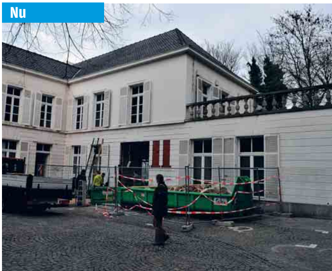
De deuropening van het beschermde gebouw werd aangepast en verbreed, zonder bouwvergunning. ©if, phkf
