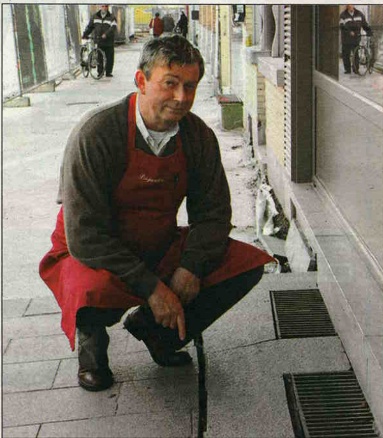
Erwin Defuster van voedingszaak Dujardin liep niet alleen schade op aan de gevel, ook binnenin werden scheuren en barsten vastgesteld. (Foto BWB)
